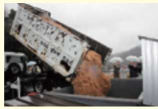
満湯の湯に導入されたチップボイラー設備
